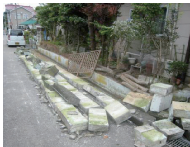
倒壊した石塀
