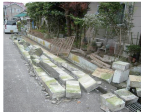
倒壊した石塀
