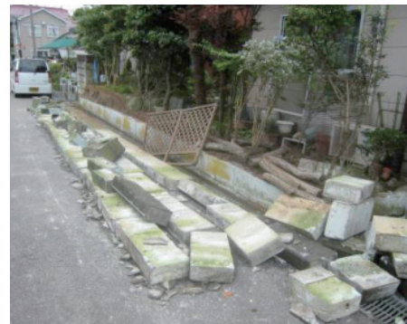
倒壊した石塀
