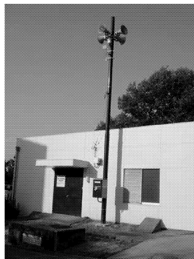
半固定型無線局全景
