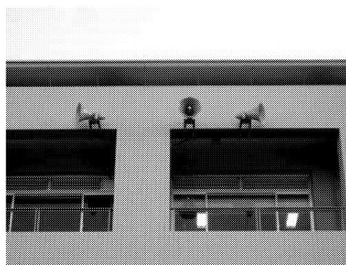
防災無線屋外スピーカー
