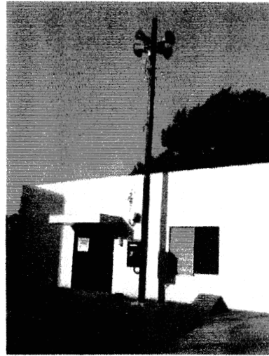
半固定型無線局全景
