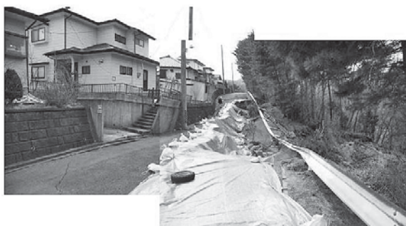
斜面崩壊(斜面F)
