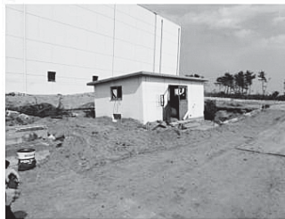
不同沈下した構造物
