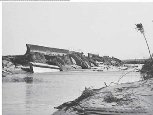
津波により破壊された防潮堤(巨理町荒浜地区)
