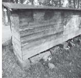
(2)トタン屋根の錆び部分 及び板壁
