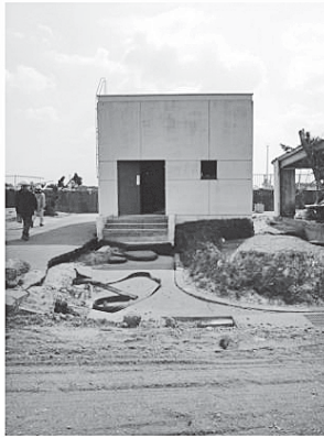
建物と舗装の間に出来た段差
