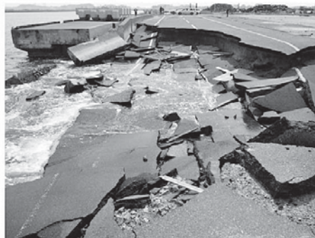
地盤の流出を伴う護岸の崩壊(相馬港)
