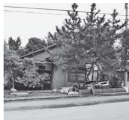
東日本太平洋沖地震(2011) 我孫子市布佐 杭による十分な支持のない直接基礎の場合、建物の不等沈下が生じやすい。
