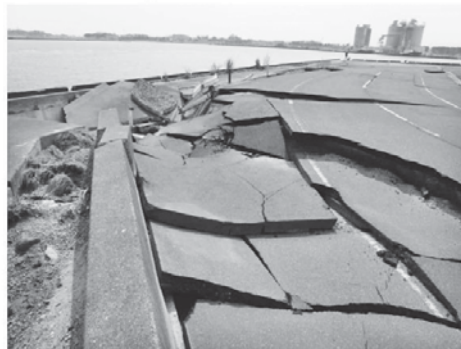
岸壁の側方流動によってできた亀裂(相馬港)
