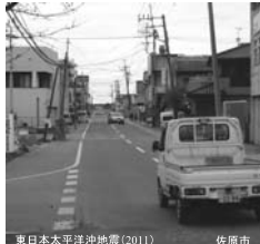
東日本太平洋沖地震(2011) 佐原市 地盤沈下が不均一に生じたため、道路がガタガタとなっている
