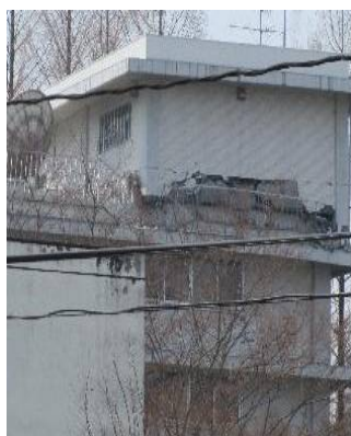
4階建て校舎の4階部分の層崩壊
