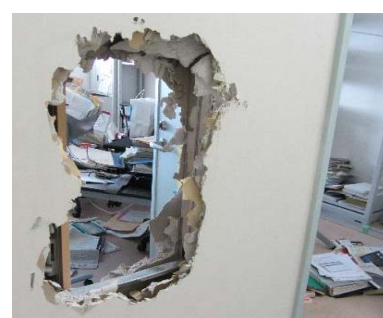
内開きのドアが開かず、壁を破って侵入した。
