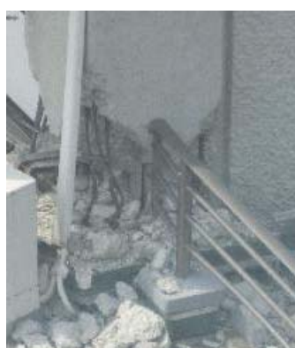
高層校舎の3階の柱の破壊
