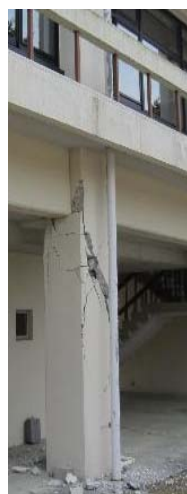
2階建て校舎の1階ピロティの柱がせん断破壊
