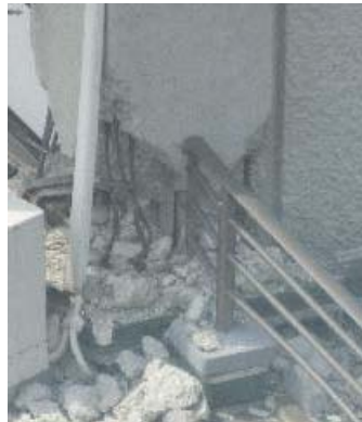
高層校舎の3階の柱の破壊
