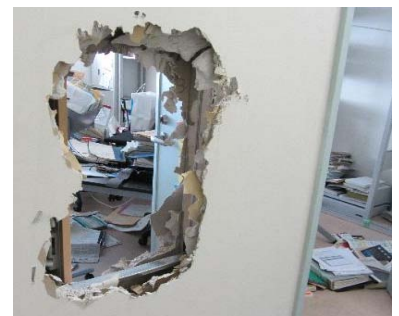
内開きのドアが開かず、壁を破って侵入した。
