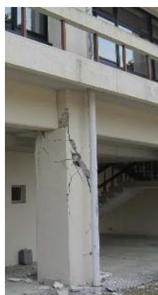
2階建校舎の1階の柱が被災した例
