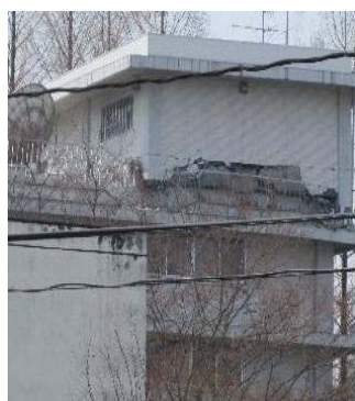
校舎の上階が被災した例
